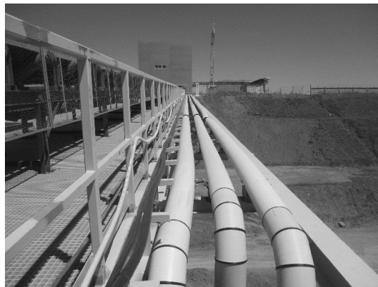
Рис. 4. Гремячинский ГОК. Пульпопровод на основе труб МУЛЬТИПАЙП ИС ПРОТЕКТ
